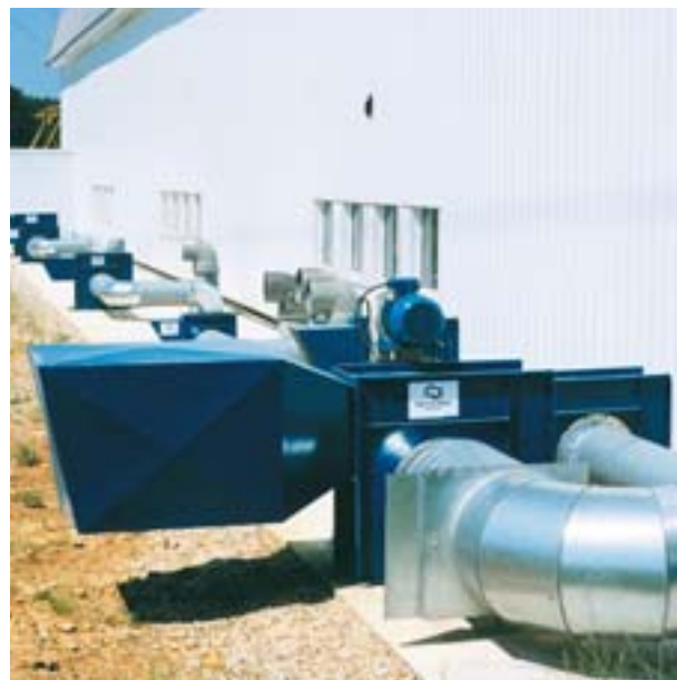
Evacuation d'air pollué sur poste de travail Extraction of polluted air from a working station
