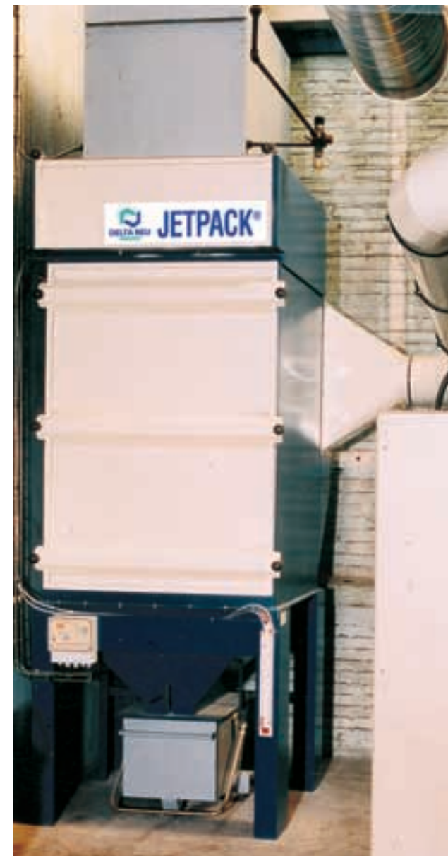
Dépoussiérage sur ensachage. Filtration on packing line.
