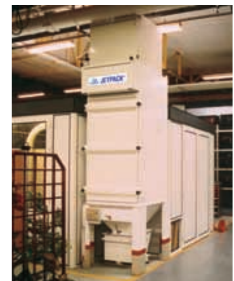
Dépoussiérage de machine d'émerissage automatique. Filtration on automatic coating process.
